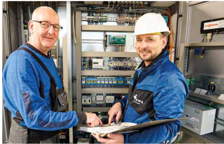
Sie sorgen dafür, dass die Stuben in Anklam warm bleiben: Kesselwärter Volkmar Hoth (links) und Stadtwärmemonteur Dirk Obernier.
