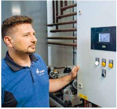
Dirk Obernier kann im Heizwerk am Display die Druckzustände in den Ausgleichbehältern ablesen. Foto: Andreas Meenke
